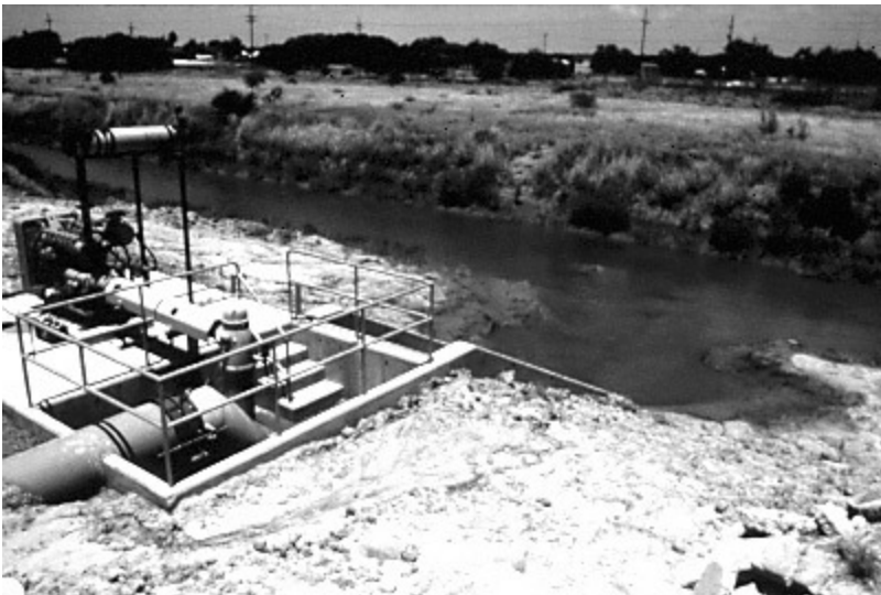
Fig. 15.6. Recirculation pump at AAA.
